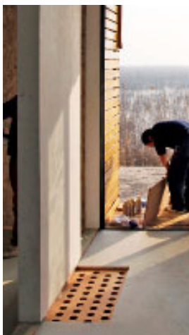
4 现场安装时的室内
