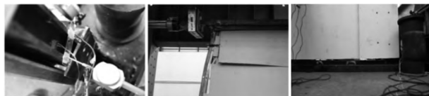
(a) 焊点脱开 (b) 木墙板纵梁压坏 (c) 木墙板翘起
